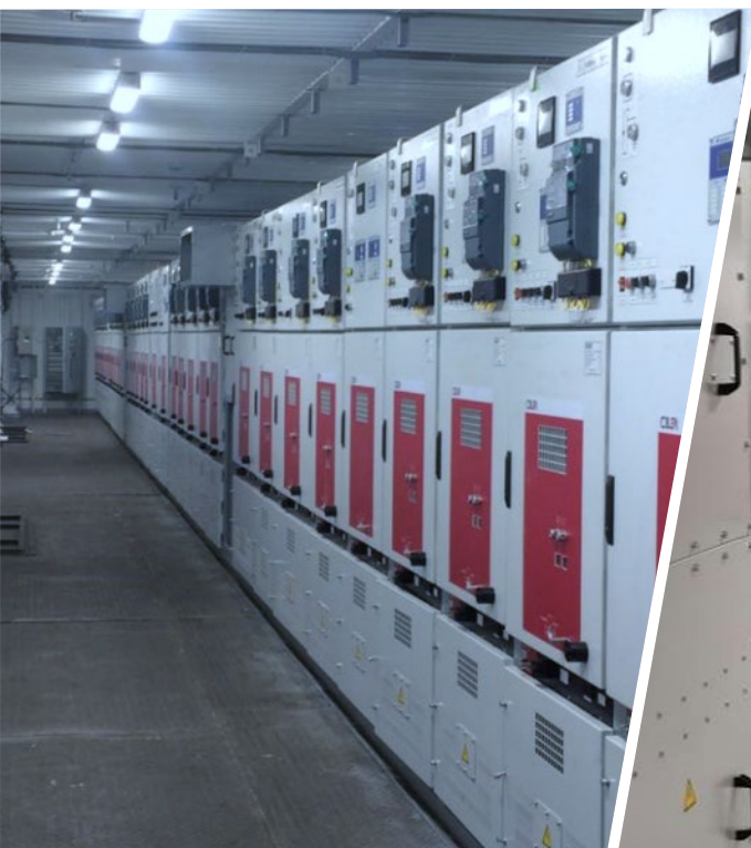
Таас-Юрх Нефтегазодобыча ПС 110/35/10 кВ "ЦПС"
